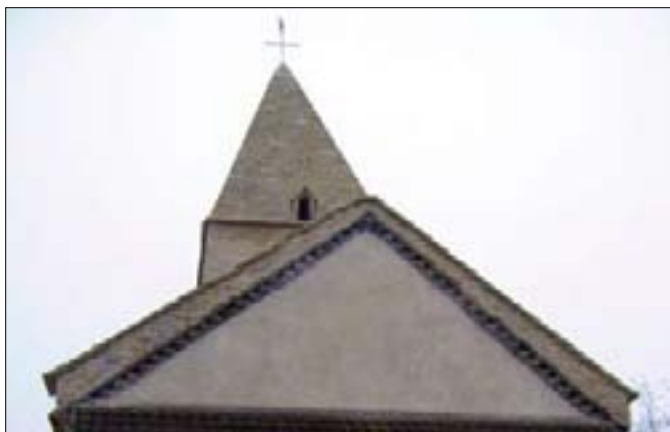
Fig. 30 - Le pignon oriental de l'église du Breuil : au-dessus des rampants à modillons d'origine, le rehaussement inadapté et disgracieux dû à la couverture en laves réalisée en 2010.
